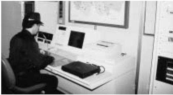
市役所にある防災無線管理室
