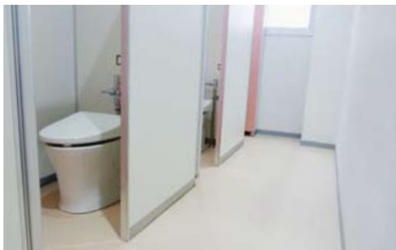
洋式化が完了した広見小学校トイレ
