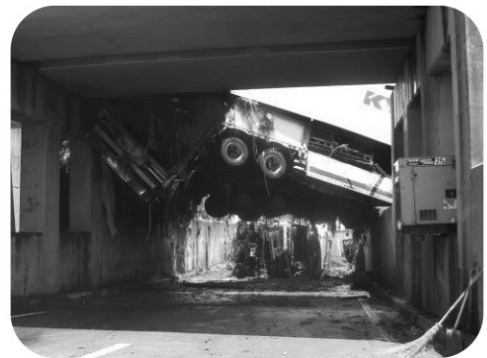
市道50号線アンダーパス災害直後の様子
