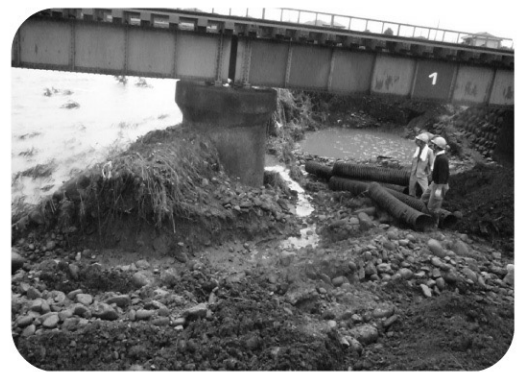
広見地内の破堤した堤防
