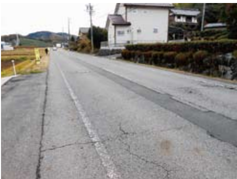
不明瞭なセンターラインと外側線
