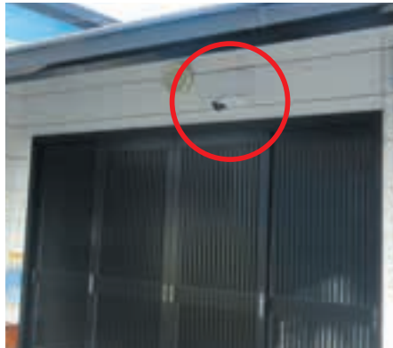
設置された防犯カメラ
