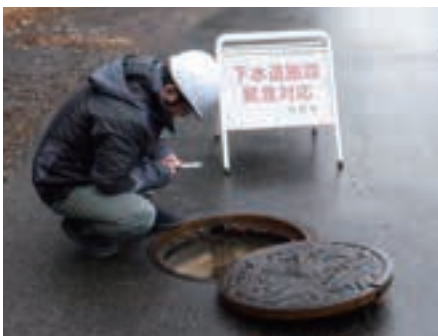
市が緊急点検を実施したマンホール(大森地内)
