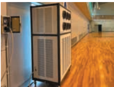
移動式エアコン活用例 (須坂市北部体育館)
