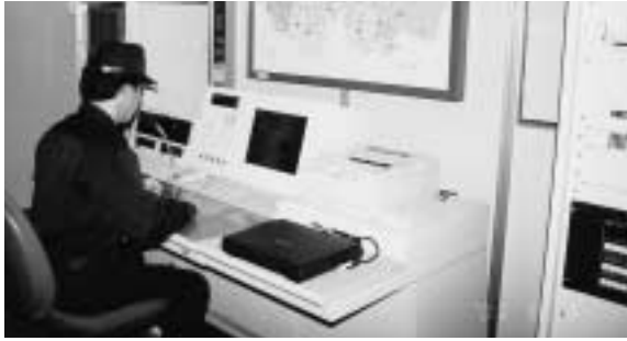
市役所にある防災無線管理室
